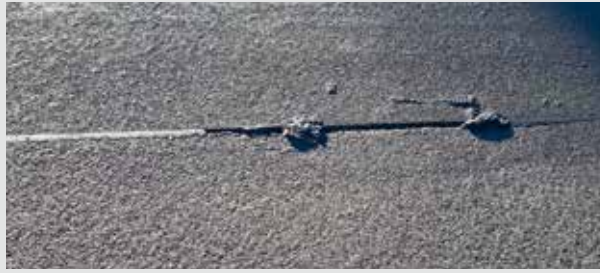
Bild 6: Aus der Fuge herausgezogene Heißvergussmasse
