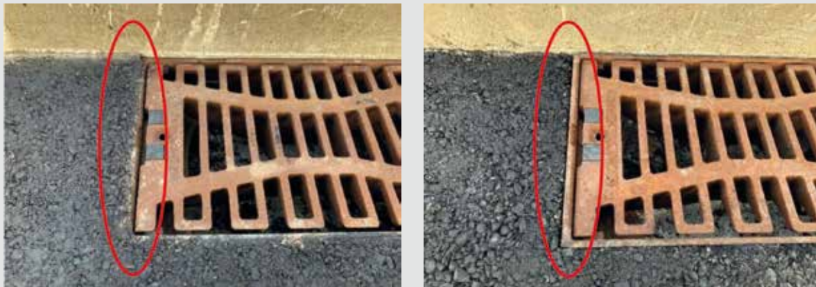
Bild 10: Ordnungsgemäß ausgebildete Fuge mit einem Bitumenfugenband (links) und ein Anschluss ohne Fugenausbildung (rechts) [Meinel 2021]
