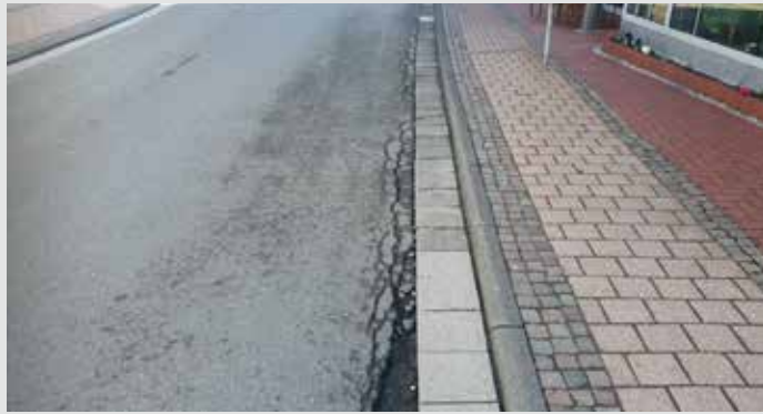
Bild 4: Schadhafter Anschlussbereich zwischen Asphaltdeckschicht und Rinnenbordsteinen
