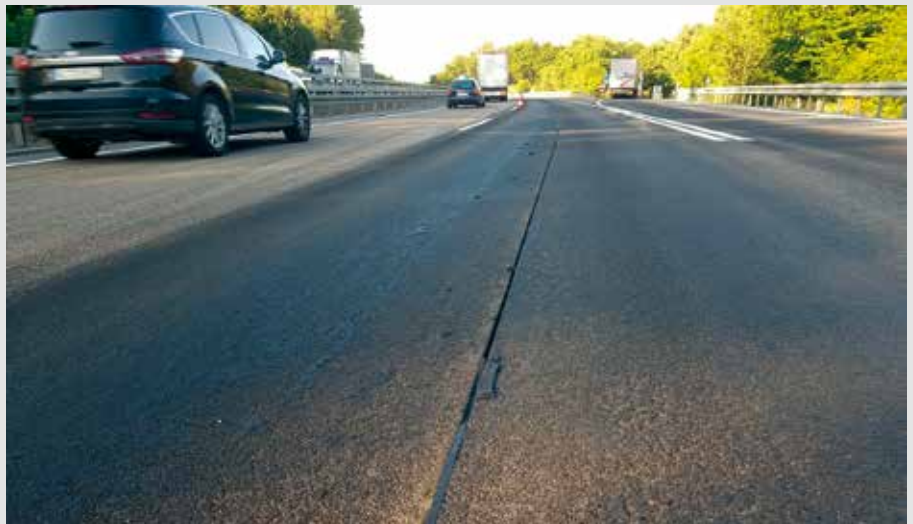
Bild 7: Aus der Fuge herausgezogene Heißvergussmasse und verunreinigte Fahrbahn
