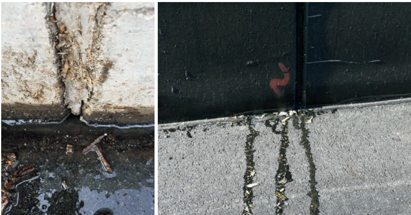
Abbildung 2: Schadhafte Fugen außerhalb und innerhalb von Bauwerken
