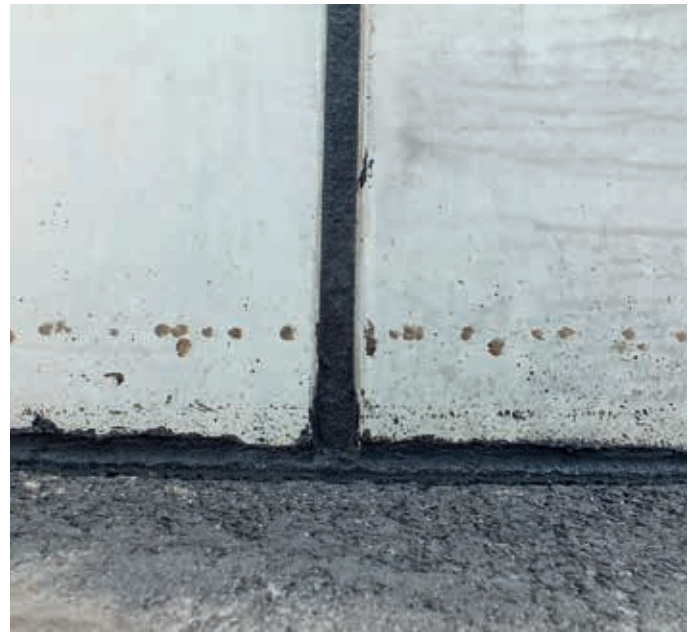
Abbildung 3: Kreuzpunkt von (Asphalt-)Boden mit (Beton-)Wandanschluss.
