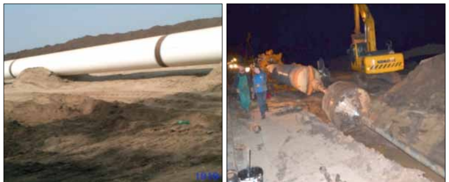
Abbildung 5 : Rohrleitung mit DN 1400 in Krasnodar, Russland
