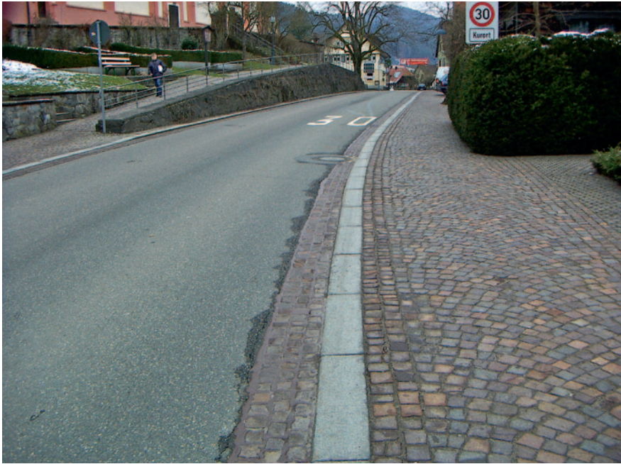
Abbildung 12: Vergossene „Problemfugen“ in einer Pflastersteinrinne
