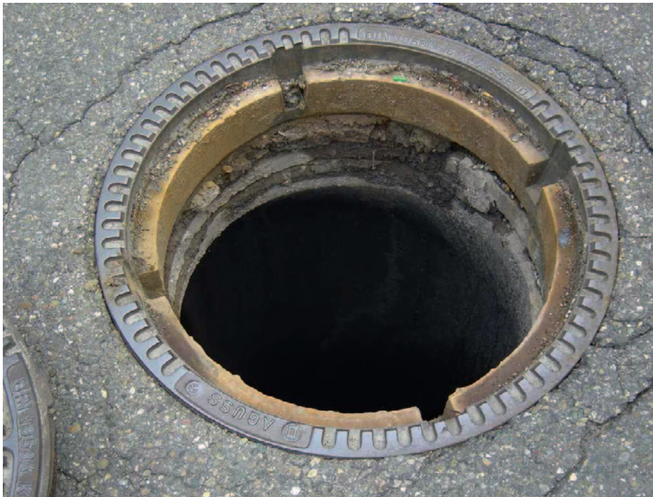
Abbildung 1: Zerstörte Schachtfuge. Fotos: Denso
