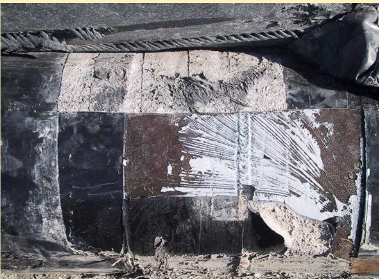
Bild 7. Schweißnaht nach 27 Betriebsjahren.
