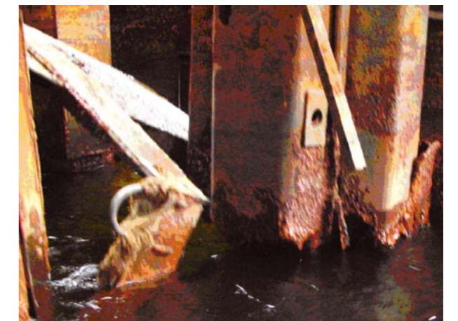
г). Разрушение покрытия в зоне забрызгивания и переменного смачивания. Срок эксплуатации 15 лет
