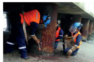
Corrosión intensa en pilotes
