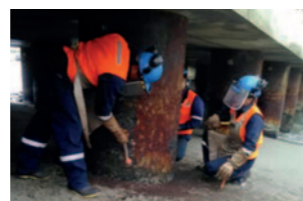
Starke Korrosion an Pfeilern
