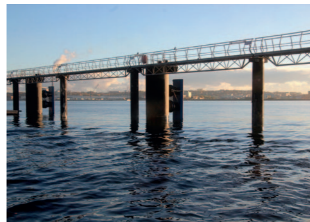
Deutschland, Hafen von Kiel, Ostseekai MarineProtect®-2000 FD Pfeilerschutz am größten Kreuzfahrtschiff-Anlegekai, DN 2400 (96")
