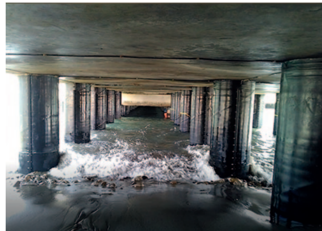
Peru, Hafen von Talara MarineProtect®-2000 FD 206 Pfeiler, DN 1000 (40")
