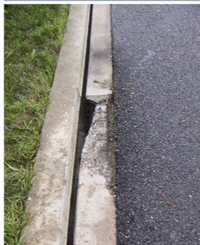
Повреждения сточного желоба Выбоины в бетоне на сточном желобе.
