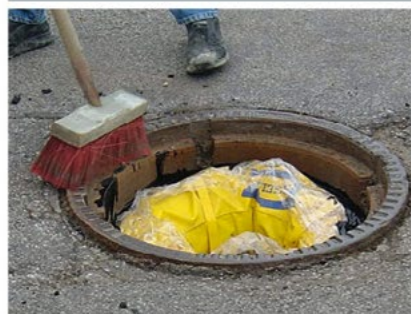
Photos de dégâts autour d'un regard Après avoir réparé le joint de mortier endommagé avec un mortier élastomère, le niveau de l'enrobé est dans la plupart des cas sous le niveau de l'anneau du regard.
