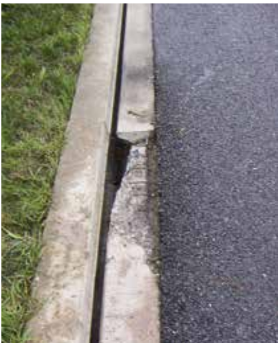
Schaden an Schlitzrinne Betonausbrüche an einer Schlitzrinne.
