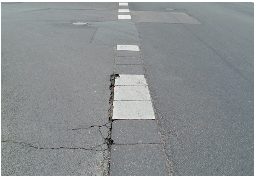
Abbildung 1: Schäden an Einbauten im Asphalt. Es wurde keine Fuge ausgebildet.
