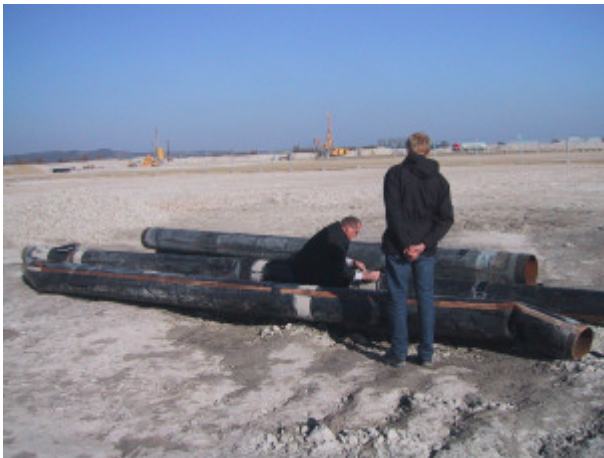
Bild 4: Ausgebaute Rohrabschnitte DN300 Fig. 4: Dismounted pipe segments DN300
