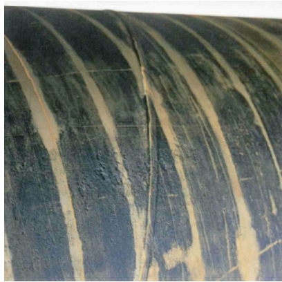
Abb. 5 Spiralkorrosion unter einem Zweischichten-Bandsystem
