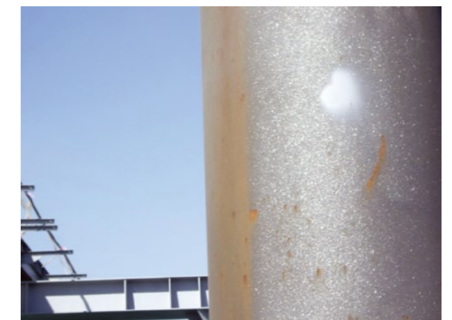
б). Разрушение покрытия в зоне забрызгивания. Срок эксплуатации 1 год
