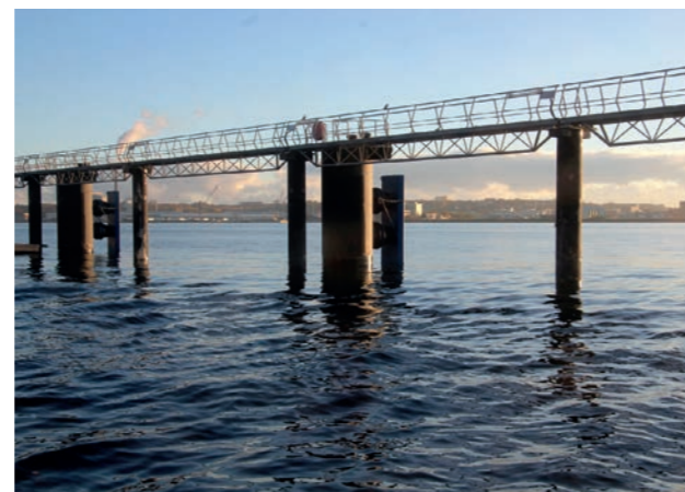
Alemania, puerto de Kiel, muelle en el mar Báltico MarineProtect®-2000 FD Protección de pilotes en el mayor muelle de atraque de cruceros, DN 2400 (96")
