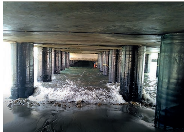
Perú, puerto de Talara MarineProtect®-2000 FD 206 pilotes, DN 1000 (40")
