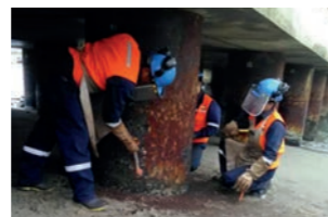
Corrosión intensa en pilotes
