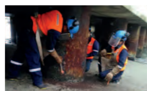
Forte corrosion sur les piliers
