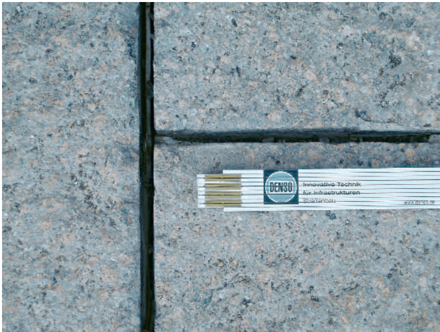
Abbildung 5: Offene Fuge vor dem Einbau der Profile
