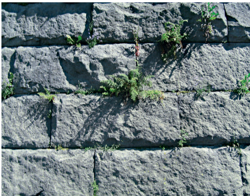
Abbildung 4: Pflanzenwuchs in den undichten Fugen
