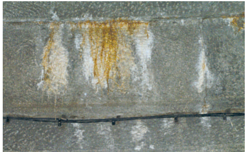
Abbildung 3: Ablagerungen an einer undichten Fuge
