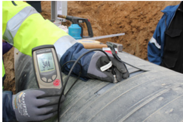
Bild 9: Restdickenmessung der Schweißnaht
