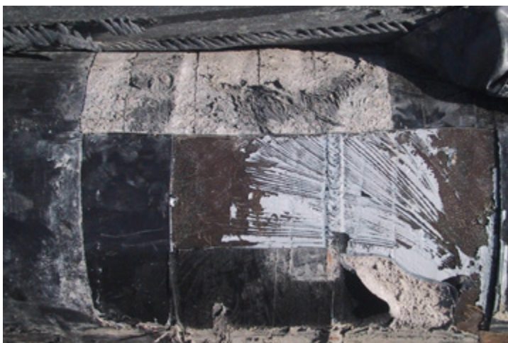
Bild 7: Schweißnaht nach 27 Betriebsjahren
