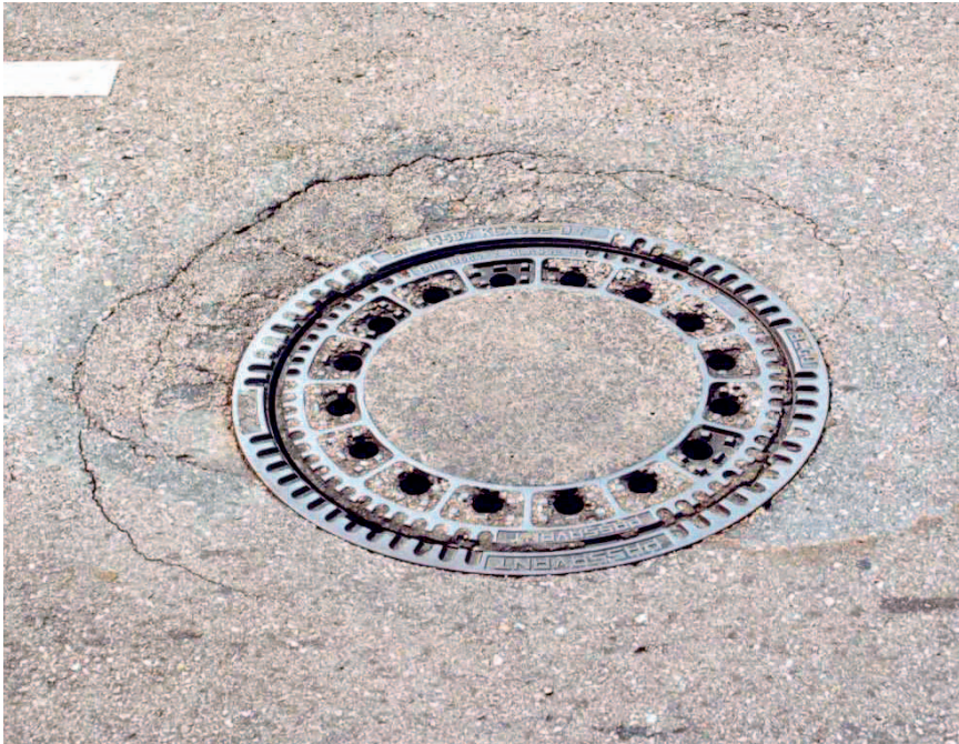
Abbildung 1: Abgesackte Schachtabdeckung, in der Folge entstehen Schäden in der Straßenoberfläche
